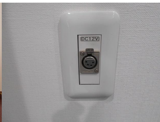
低圧 DC (12V) コンセント
