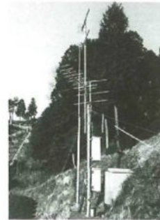
昭和56年ころのUV混合アンテナ
